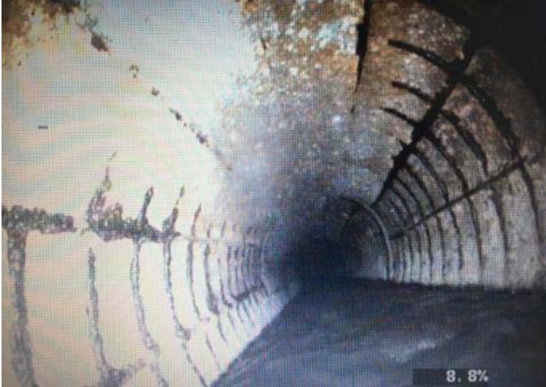
Figura 9. Hormigón interior de los colectores completamente degradado y con las armaduras visibles, completamente oxidadas
