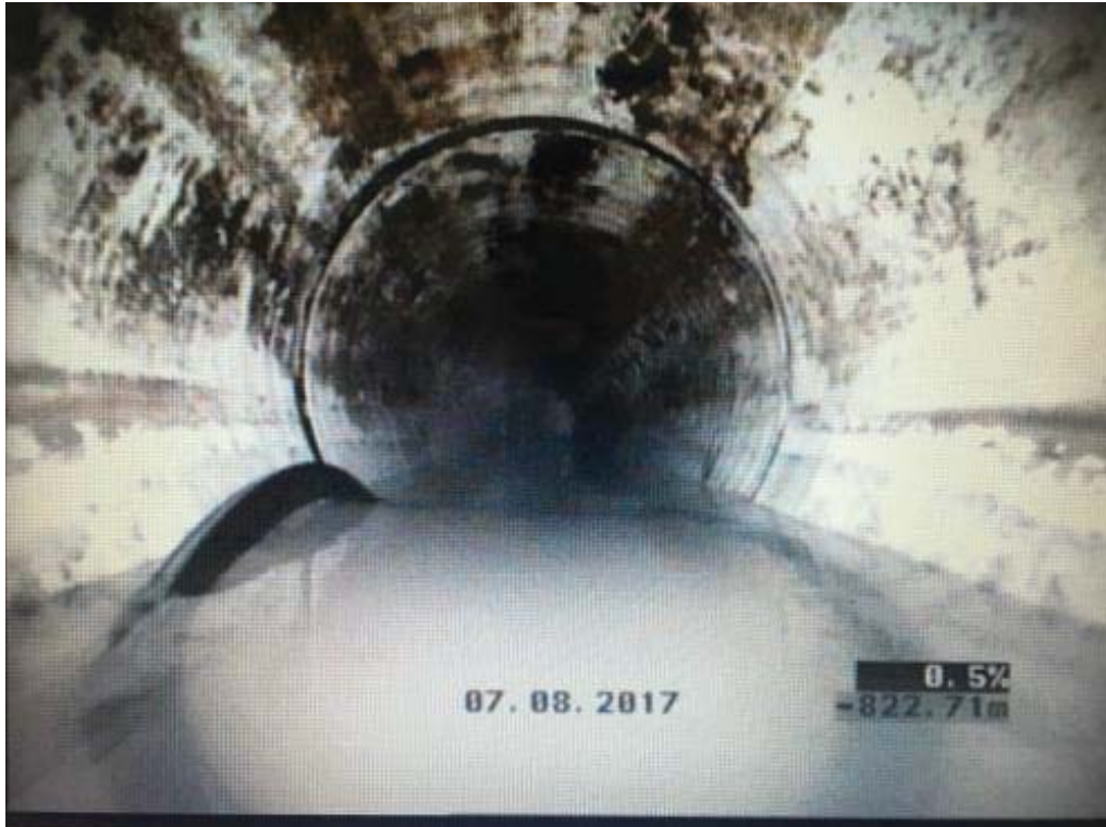
Figura 5. Juntas de unión entre las tuberías sueltas y desprendidas.
