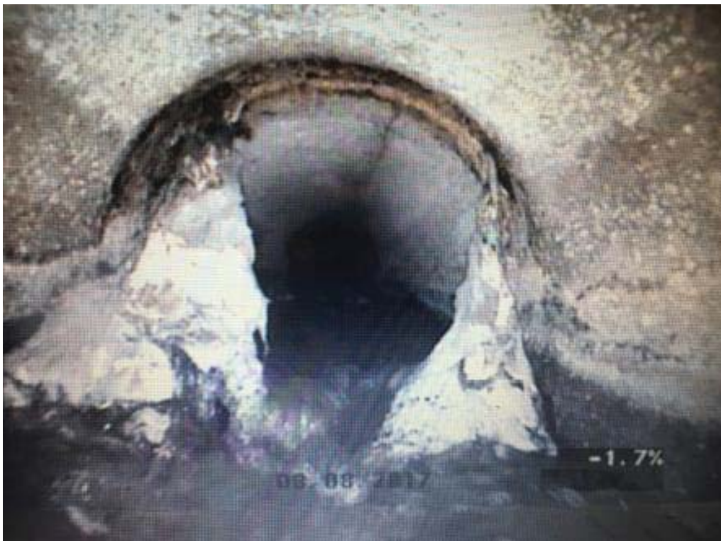
Figura 6. Resaca e Ingenieros Cíviles acumulada en su superficie interior.
