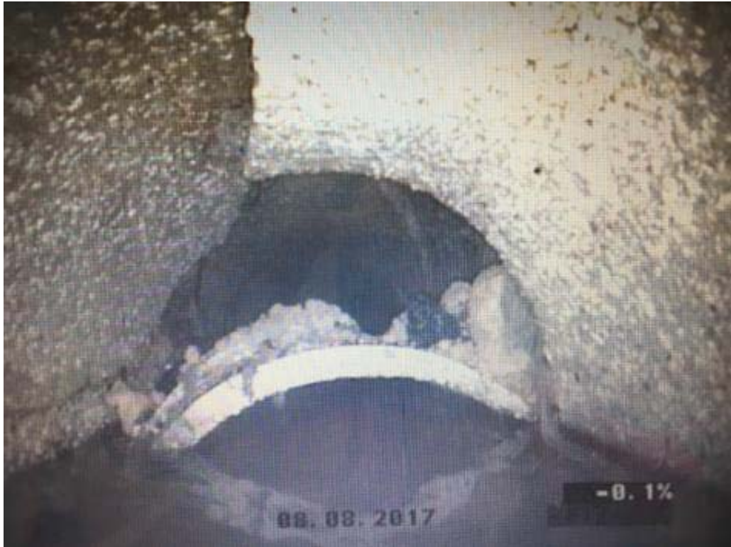
Figura 7. Tramos de tubo completamente hundidos y sin ningún tipo de continuidad lineal.
