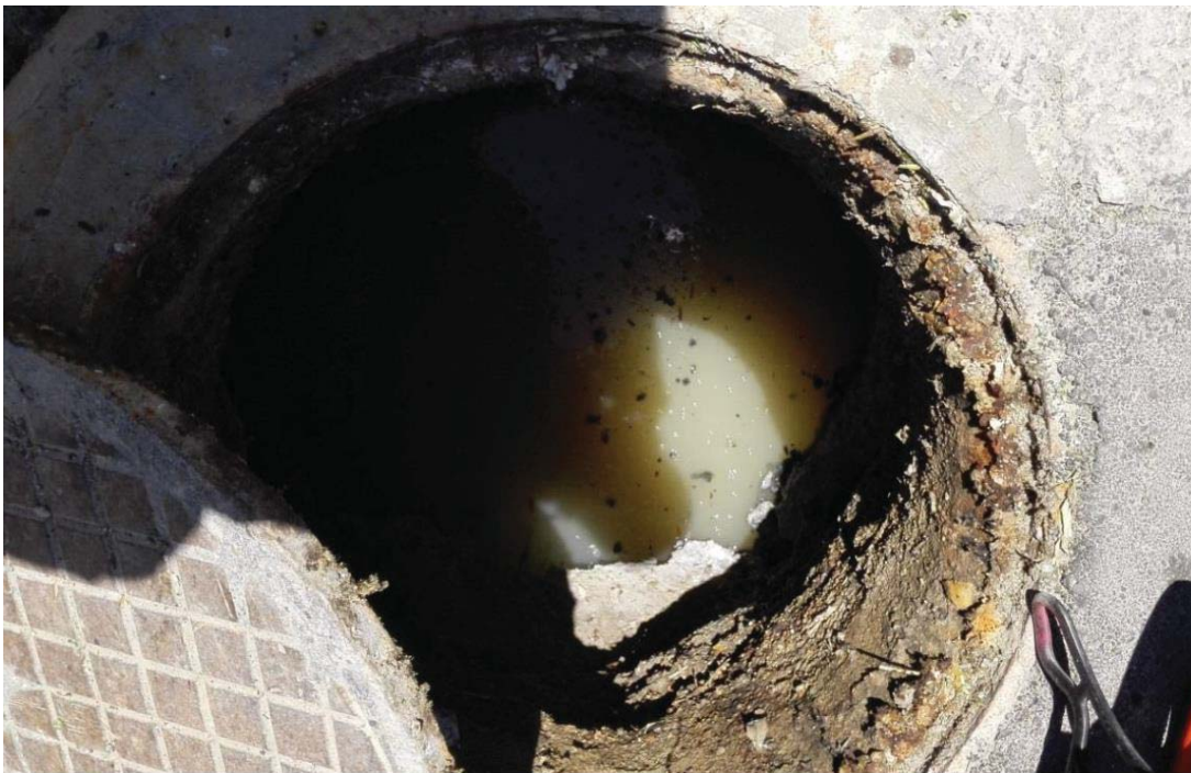
Figura 10. Pozo donde se observa que el colector está totalmente completamente lleno en el tramo que discurre entre la Av. De la Máquina Fija y la C/Compositor Granados.
